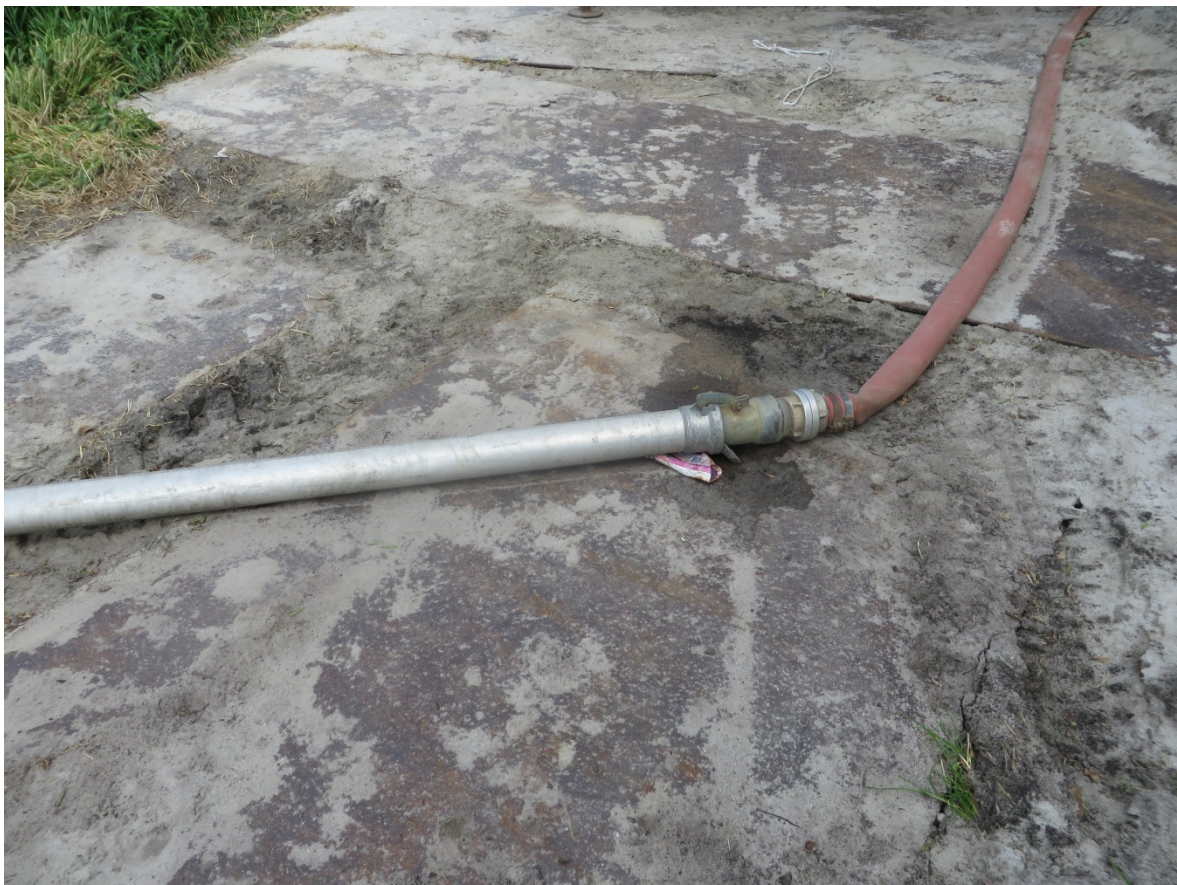
Foto 5: Aluminiumbuizen die over de percelen verlegd kunnen worden
